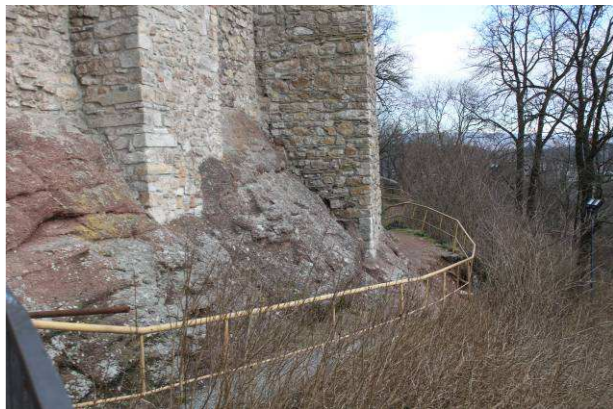
Neprostopná cesta v místě sesuvu na jižním svahu.
