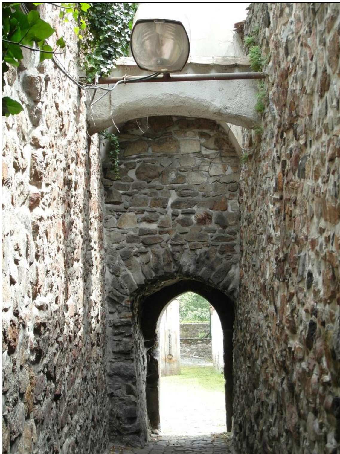
Katova ulička – oprava prampouchů a výměna pouličního osvětlení – před opravou
