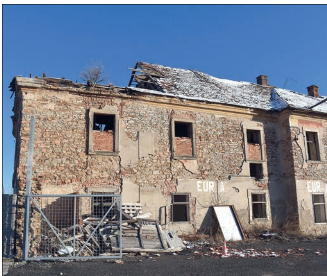
Chocenice (správní obvod ORP Kolín), hostinec Zlaté Slunce, jeden z mála autentických zájezdních hostinců na staré císařské silnici z Prahy do Kolína, s ručně tesaným krovem vaznicové soustavy se stojatou stolicí z poloviny 18. století, dne 18. 12. 2023 došlo ke zhroutilí západní valby (foto D. Havlíková).
