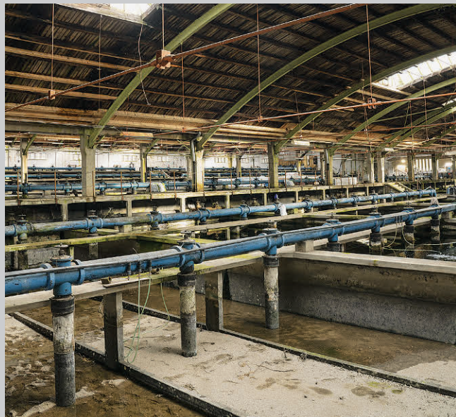
Interiér s filtračním zařízením
