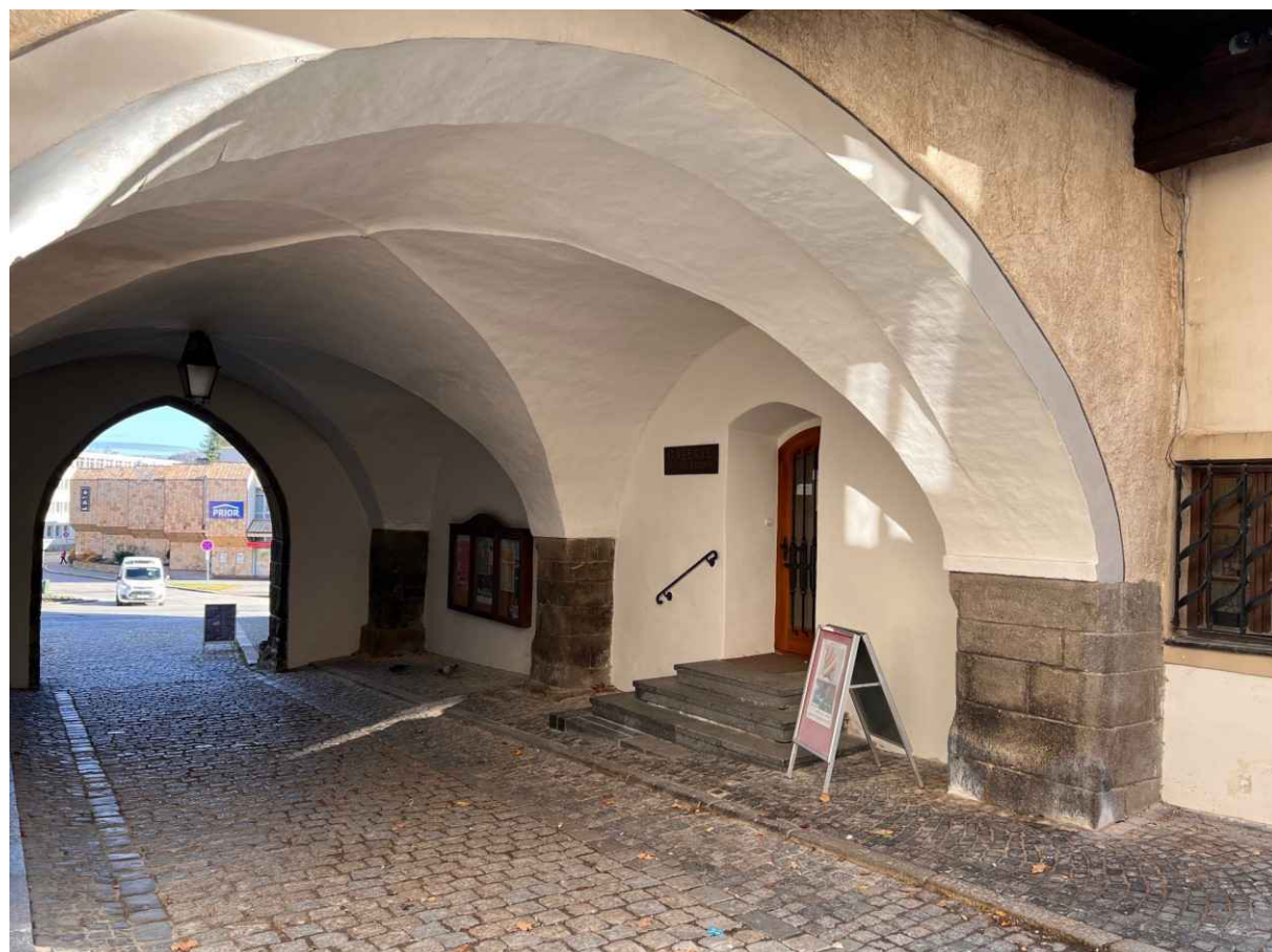
Dolní brána – oprava omítek v průjezdu Dolní brány a zdi u vchodu do Parkánu, červenec 2023
