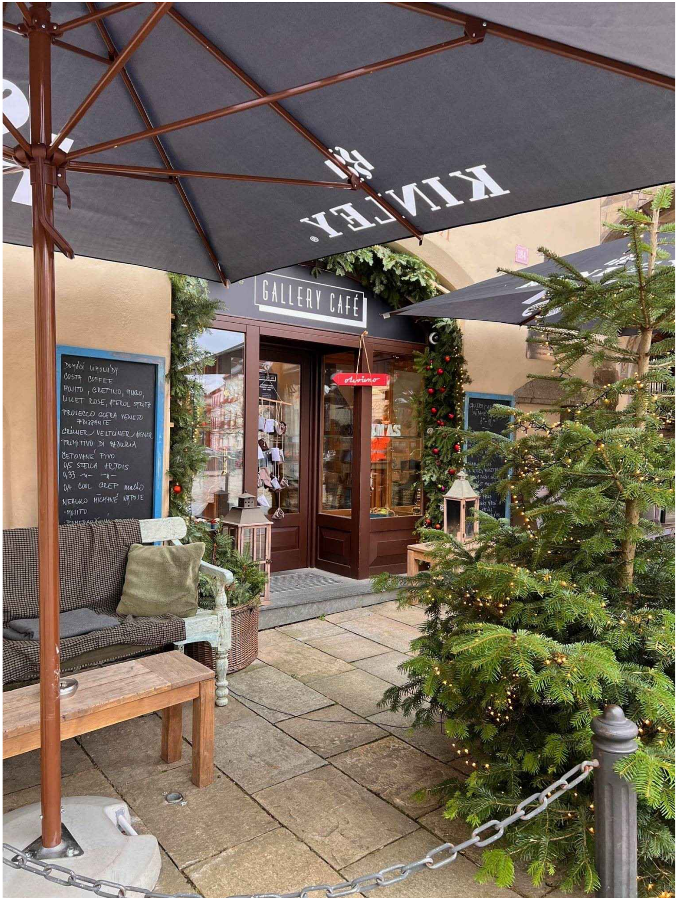
Měšťanský dům č.p. 184 – obnova interiéru za účelem zřízení kavárny Gallery Café, listopad 2023
