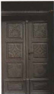
Pavlov, dům čp. 49, vstupní dveře před opravou.
