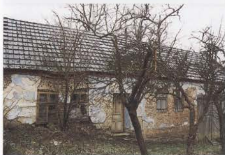
Nová Lhota. Chátrající stav objektu z 20.–30. let 20. století.
