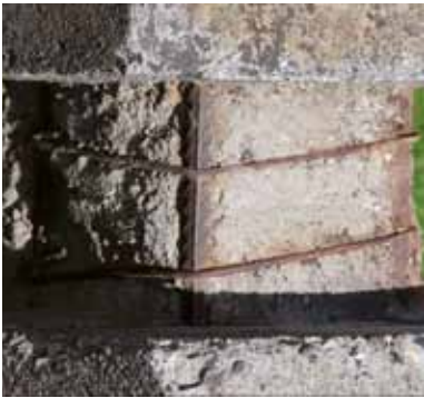
Stav koroze ocelových armatur před demontáží díla (foto Tomáš Skalík, březen 2013).
