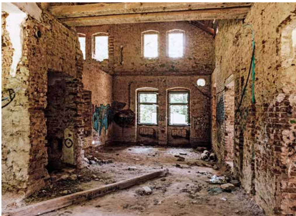
Obr. 5. Jindřichův Hradec, Nežárcká čp. 121, výletní restaurace Rudolfovo, devastovaný interiér budoucího výčepu, foto: Miloš Bučinský, 2020
