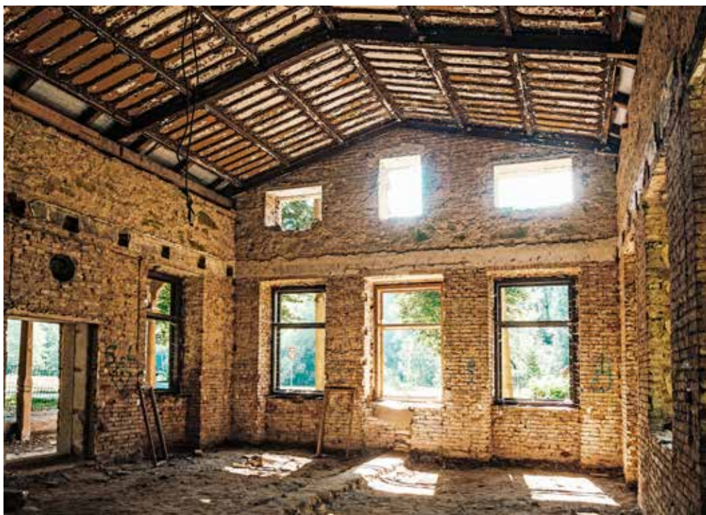
Obr. 6. Jindřichův Hradec, Nežárcká čp. 121, výletní restaurace Rudolfovo, devastovaný interiér budoucího sálu, foto: Miloš Bučinský, 2020
